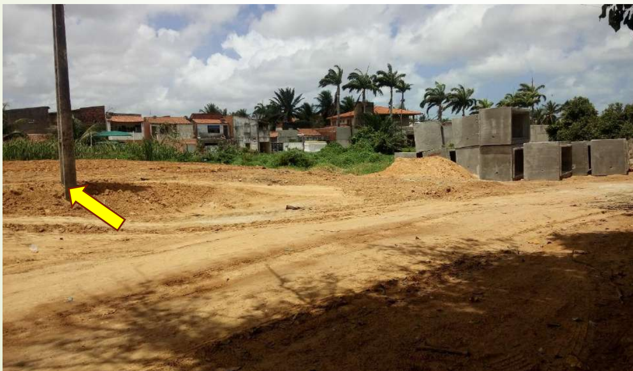
Figura 08. Poste da rede elétrica (Enel) localizado no meio da via.
