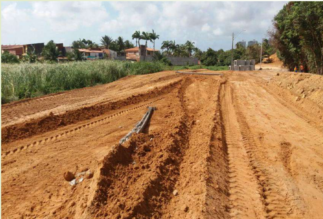
Figura 10. portes quebrados na via
