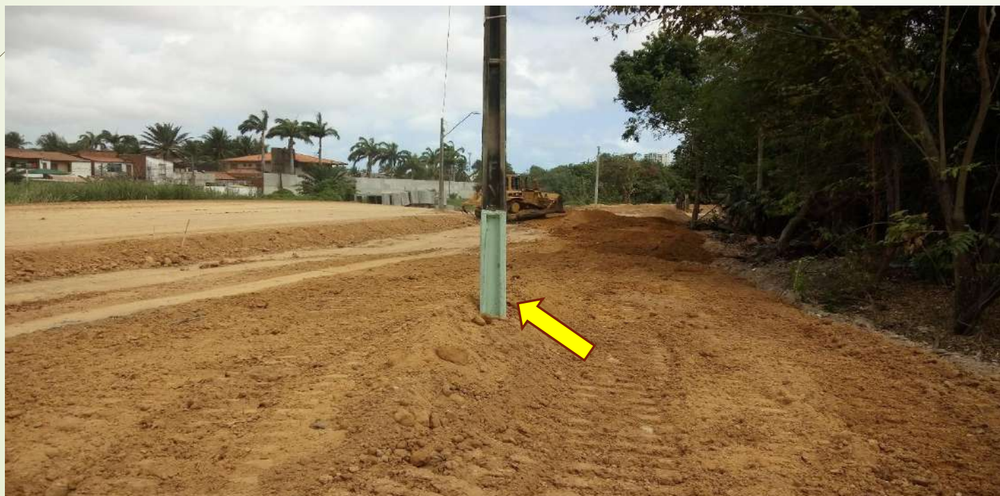
Figura 04. Poste da rede elétrica (Enel) localizado no meio da via.
