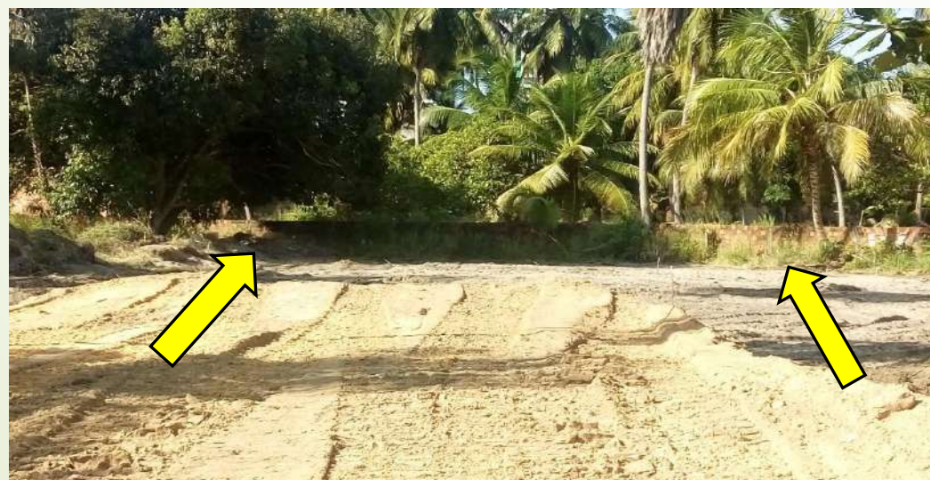
Figura 34. Muro impedindo os serviços da via
