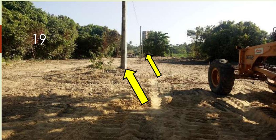
Figura 32. Portes da rede elétrica da Enel no meio da via
