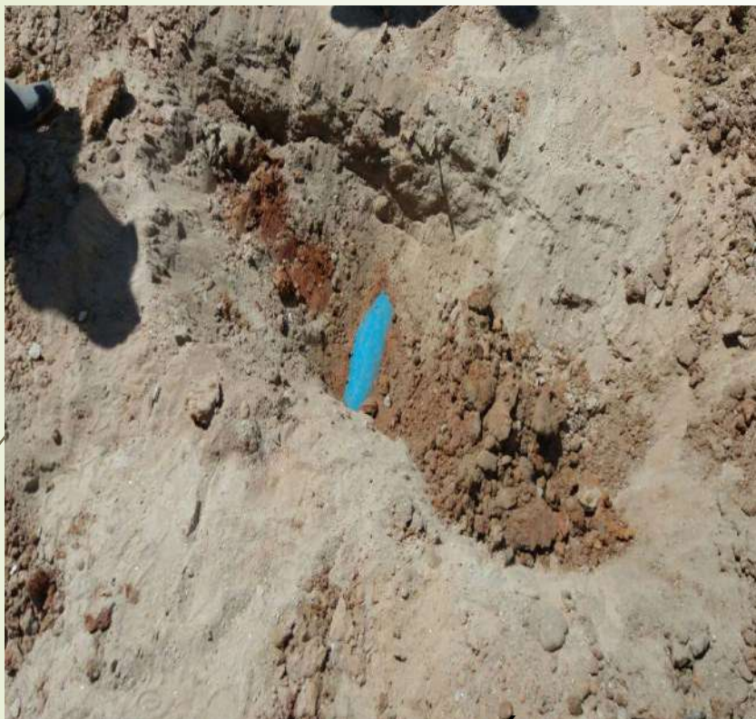
Figura 25. Adutora de Água da Cagece.
