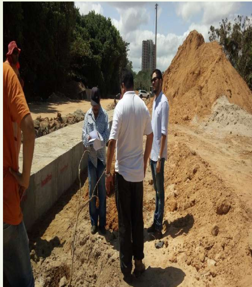
Figura 10. Visita de equipe da Cagece para fazer levantamento de deslocamento da rede de esgoto.
