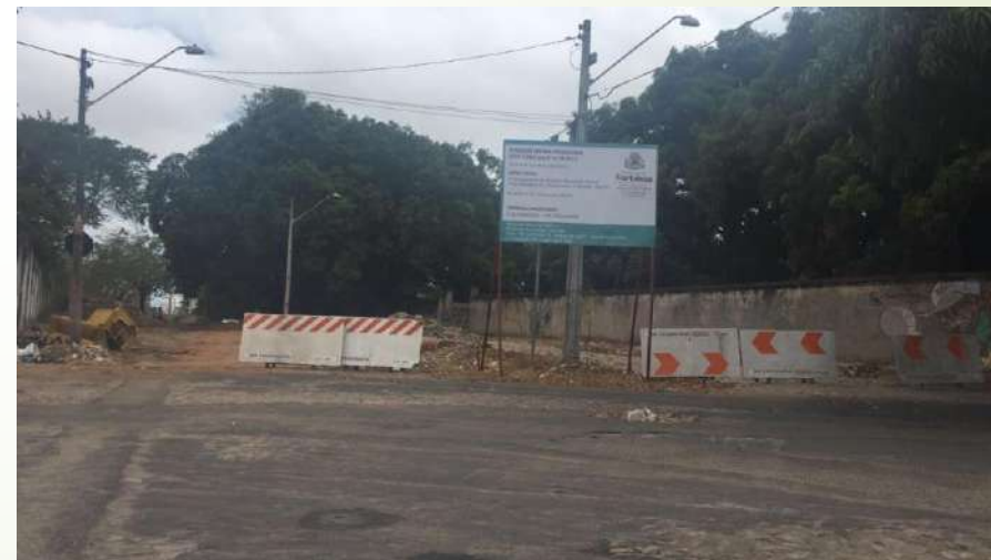
Figura 09. Placa de obra das vias – Extremidade Av. Léa Pompeu com a via local
