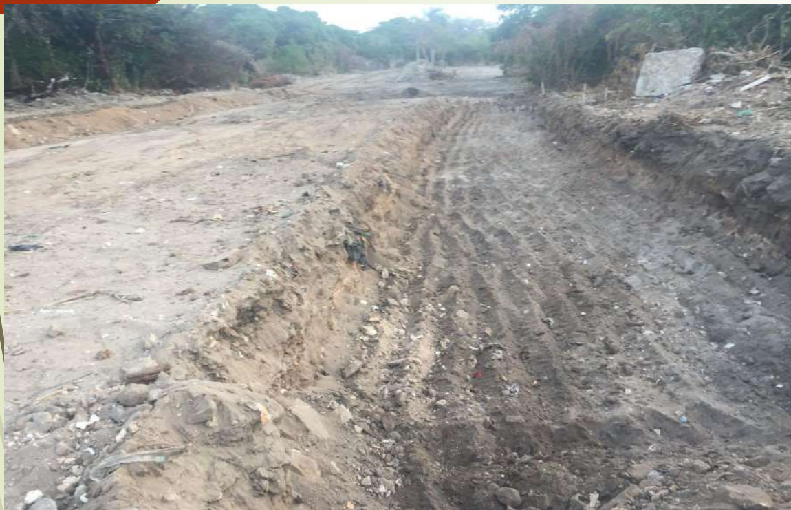
Figura 12. corte no trecho da estaca16 no lado esquerdo
