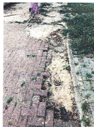
Inexistência de bloquetes.
