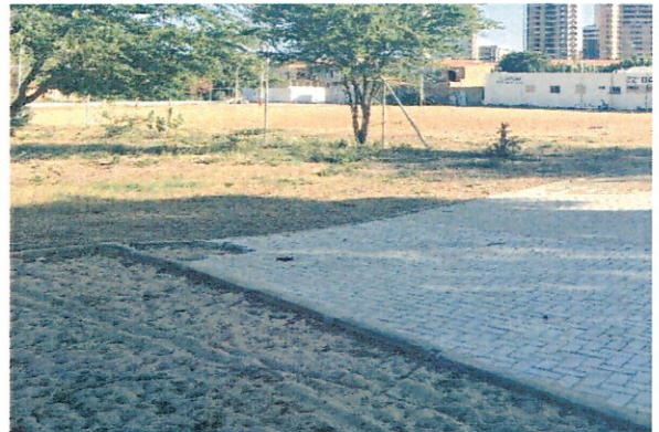
Peças recolocadas, porém com pontos faltando.
