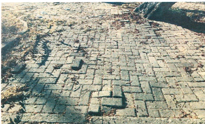
Peças irregulares. Precisa-se de manutenção.
