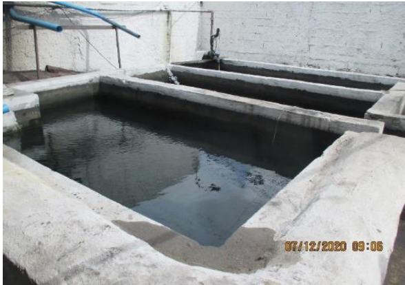
ETE de lavanderia
