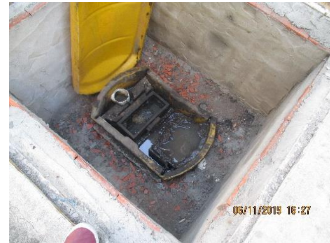
Caixa separadora de água e óleo
