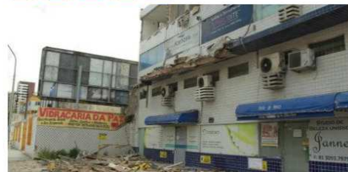
Marquise do terceiro pavimento caiu sobre as demais
